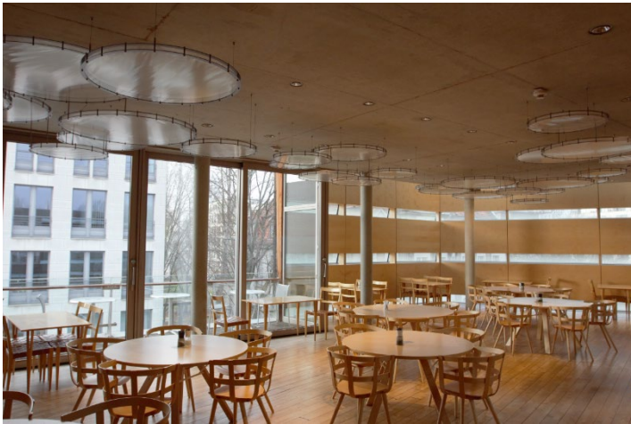
Die Brandmelder fügen sich diskret in das Ambiente der Kantine im Gemeinschaftshaus ein.
